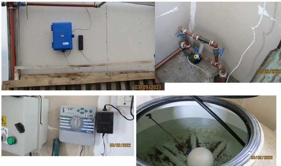
Fig. 9. Instalaciones Modulo T/H y bombeo de agua Invernadero
